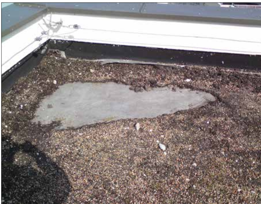
Fot. 3. Brak opaski żwirowej powoduje wywiewanie substratu
