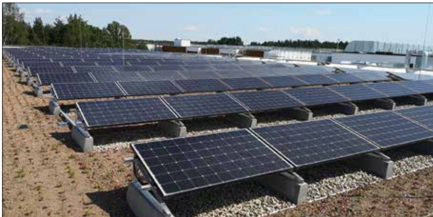
Fot. 2. Urządzenia solarne na dachu zielonym balastowym
