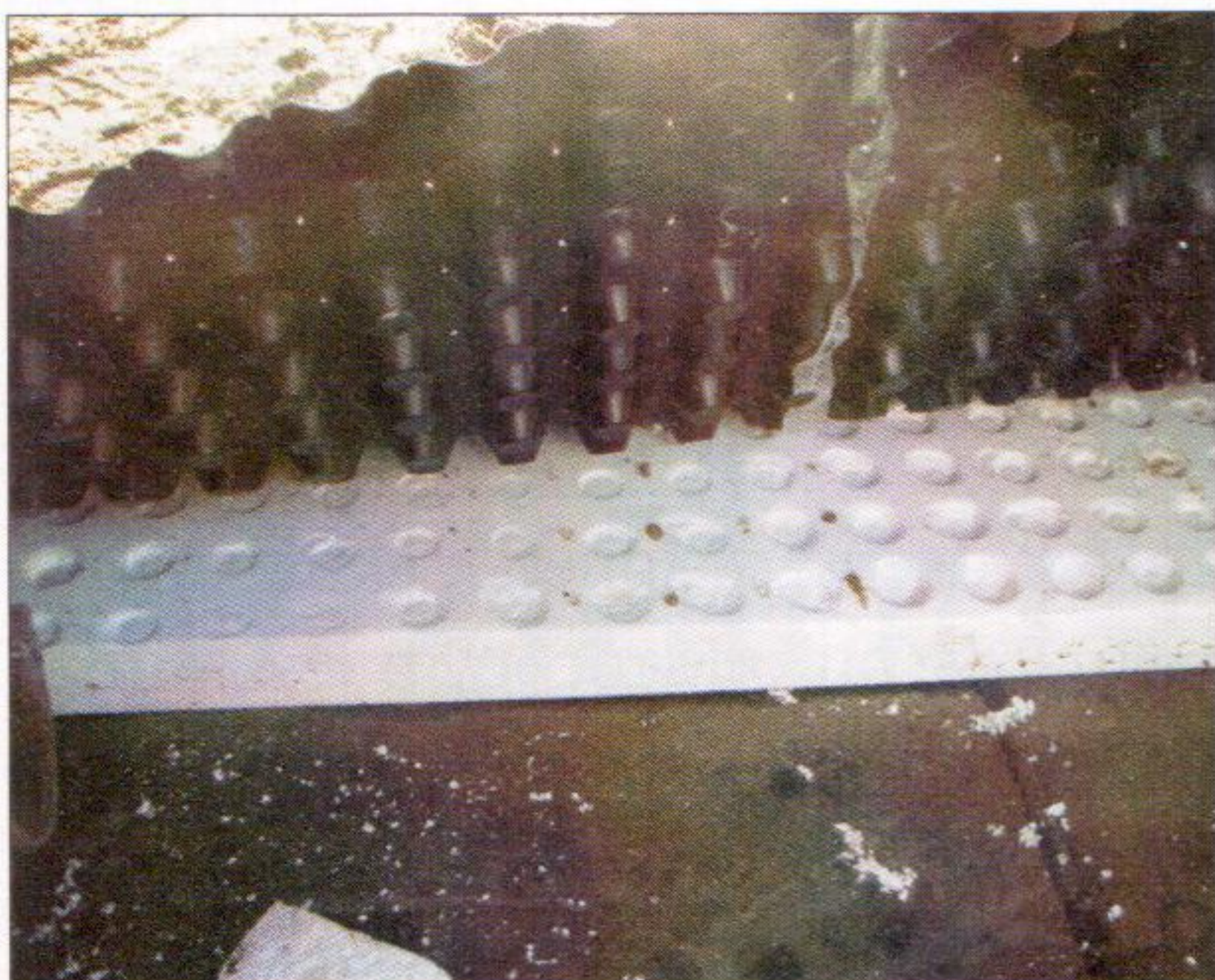
Fot. 1 | Brak geowłókniny powoduje zniszczenie termoizolacji
