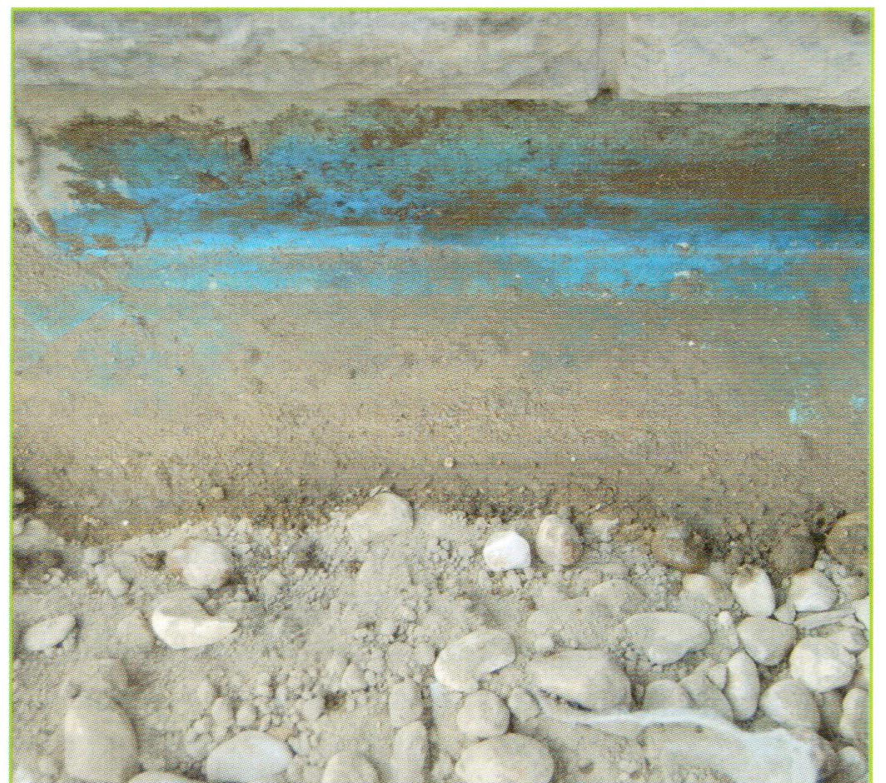
Niewłaściwie zastosowana polimerowa izolacja bezspoinowa
